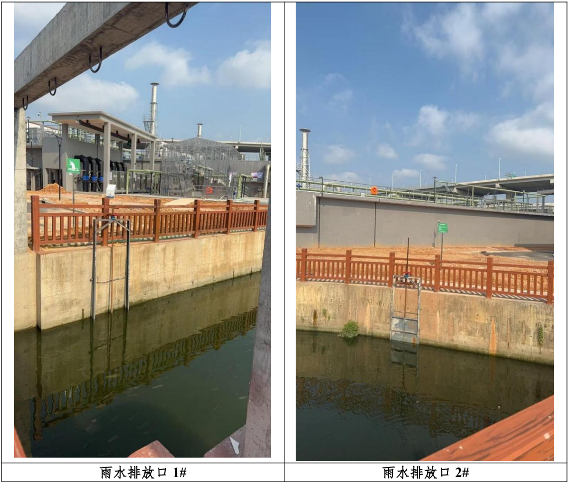
图 5.2-2 雨水排放口闸阀
