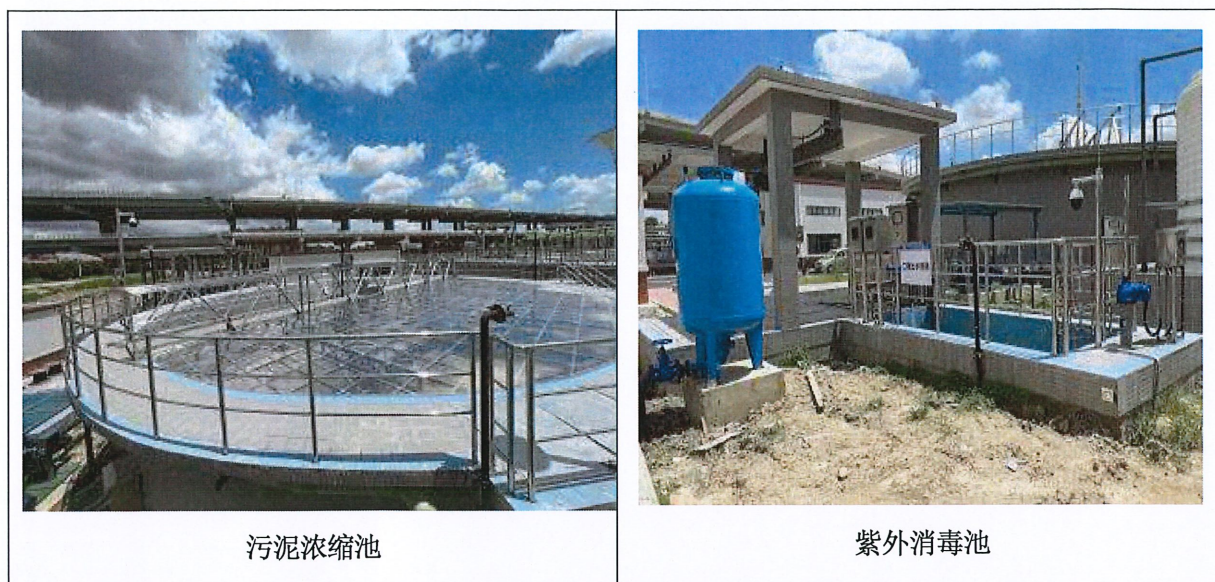
图4.1-2废水处理设施
