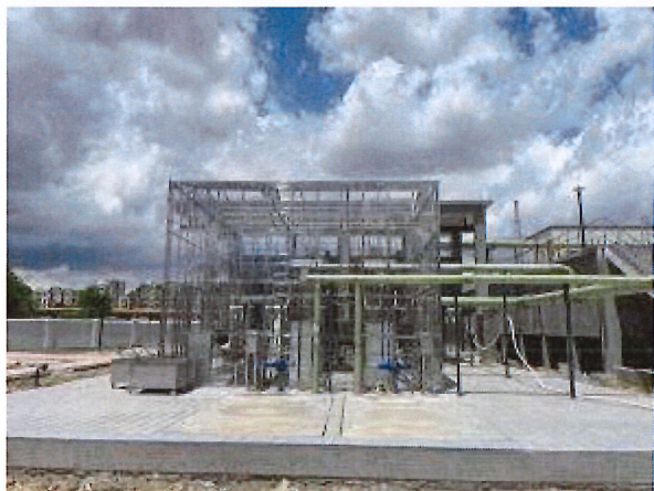
粗格栅及进水泵房
