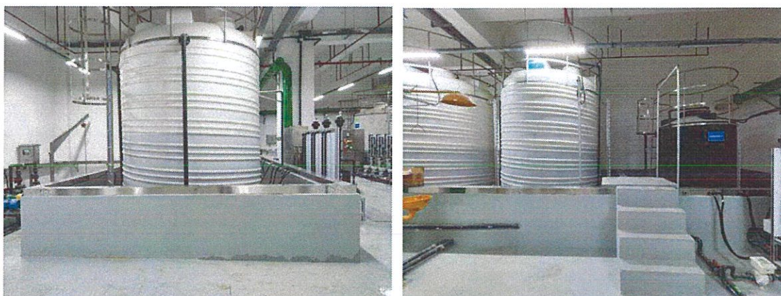
储罐设有围堰，有效防止泄漏
