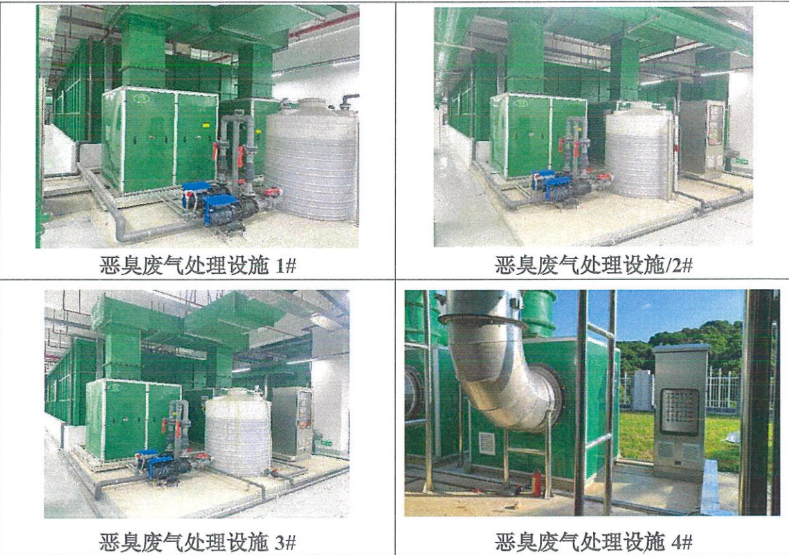
图 4.1-3 废气处理设施
