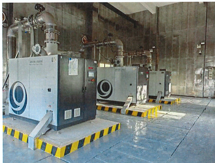
鼓风机房墙体采取隔音棉材料
