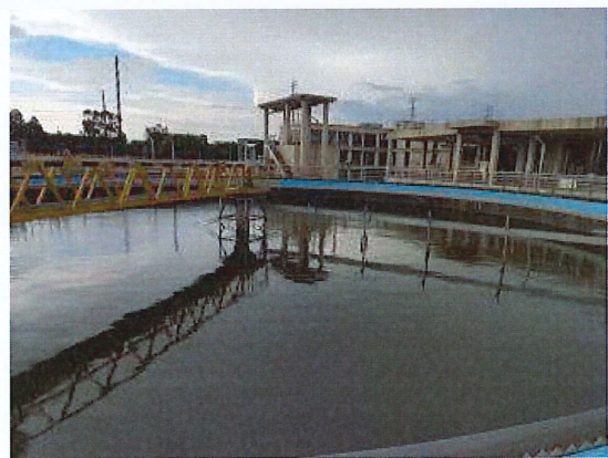
圆形周进周出二沉池
