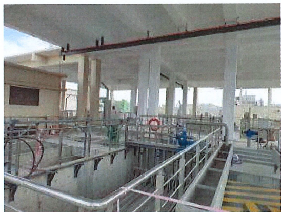
深度处理综合池
