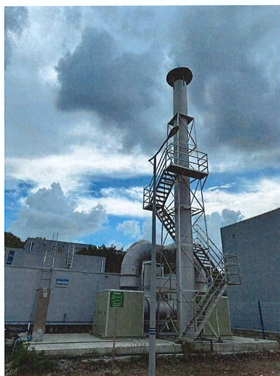
恶臭废气 1#处理设施
