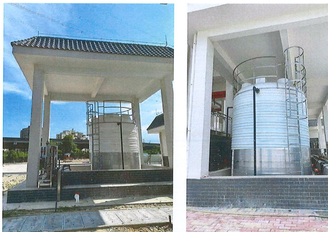
储罐设有围堰，有效防止泄漏
