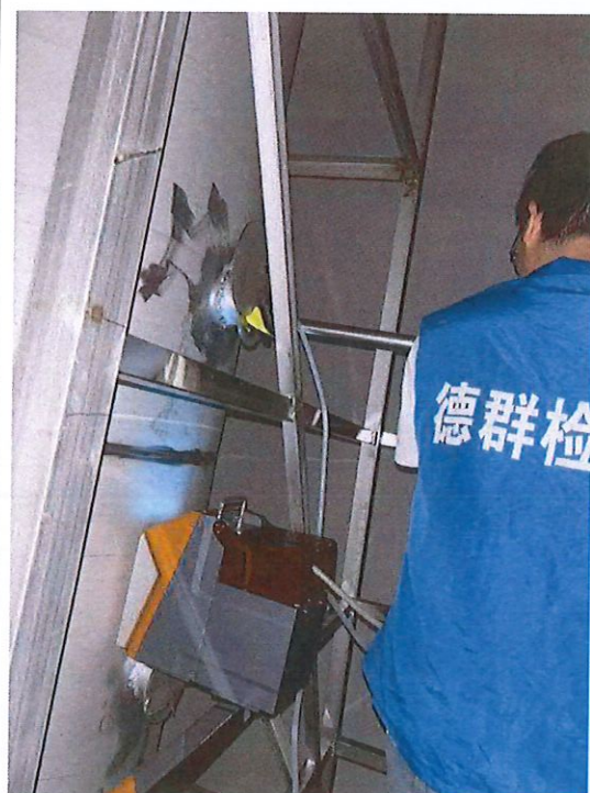
恶臭废气3 (DA003) #排放口
