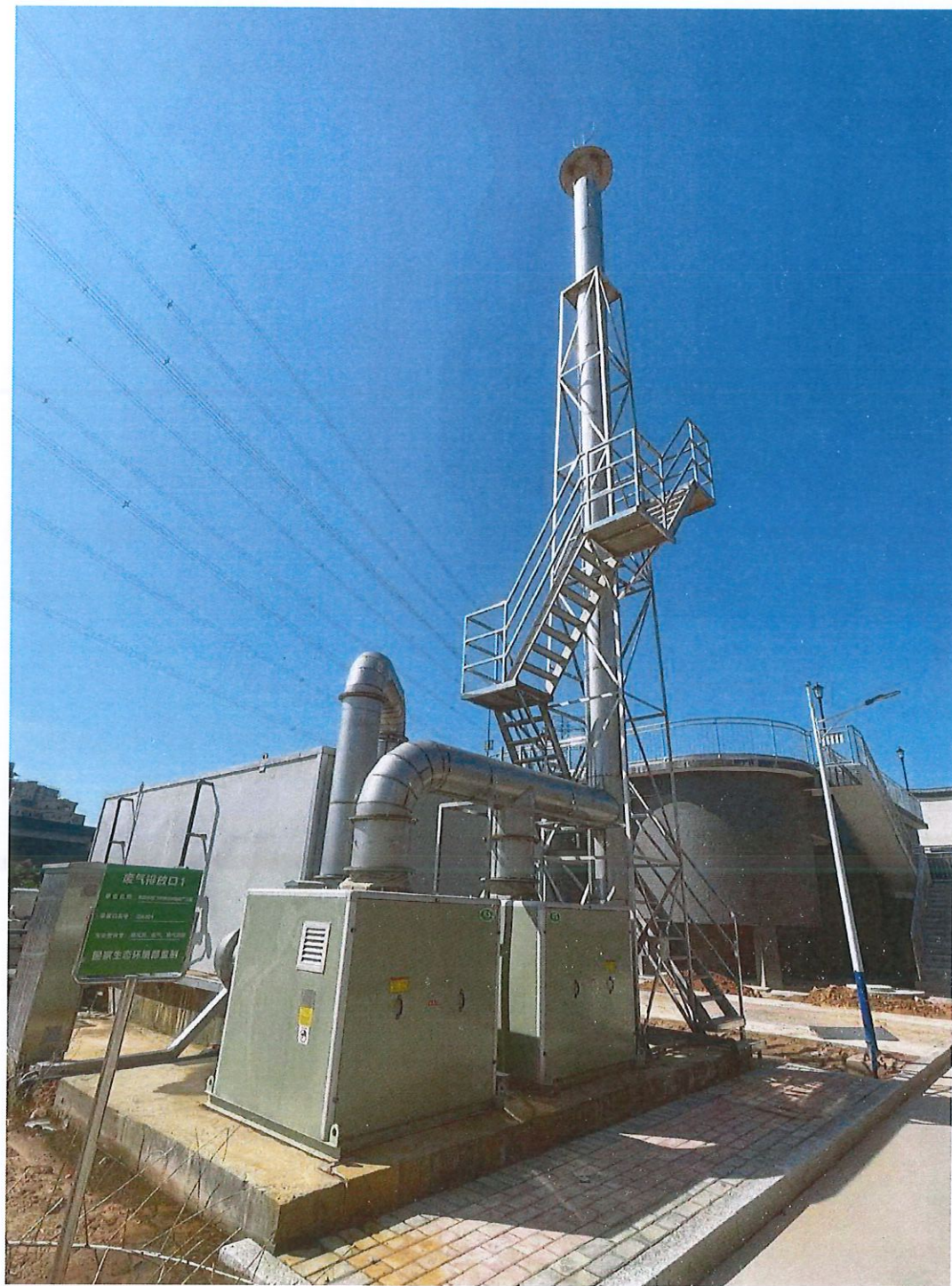
生物滤池除臭系统（A区域，预处理区）
