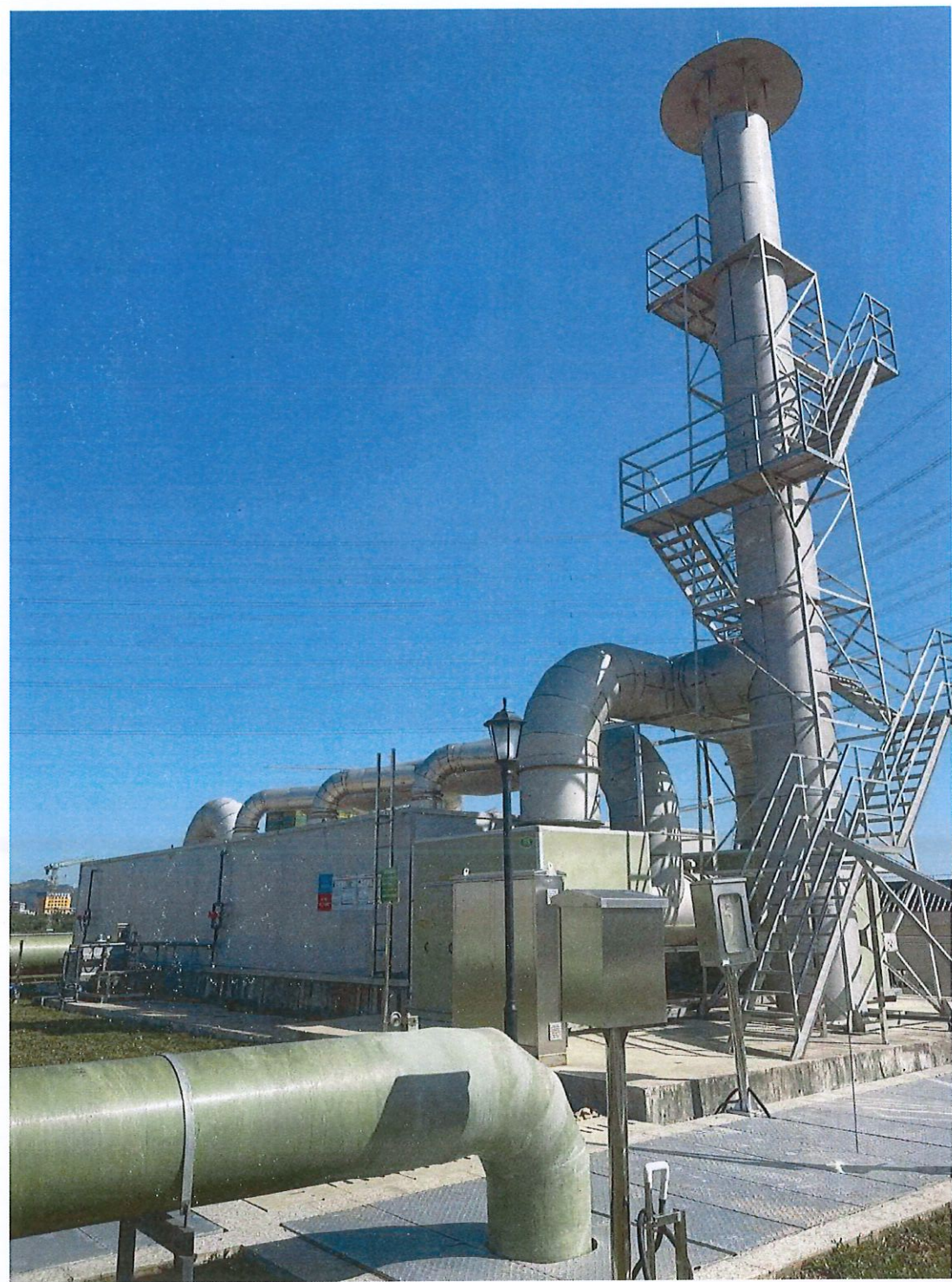
生物滤池除臭系统（B区域，生物反应区）
