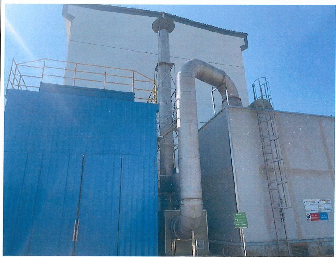
生物滤池除臭系统（C区域，污泥处理设施）
