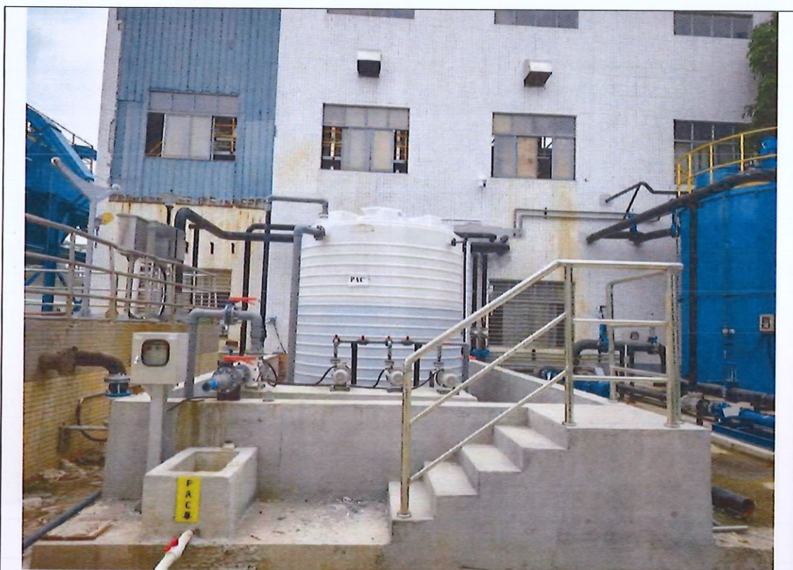
PAC 储罐及围堰（污泥脱水机房）
