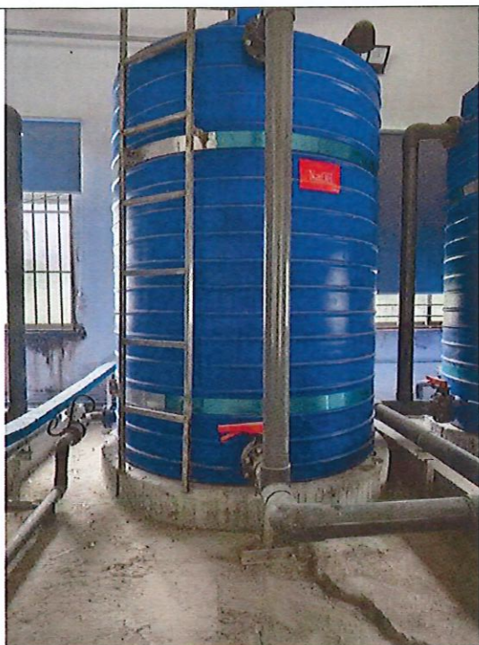
液碱储罐及围堰
