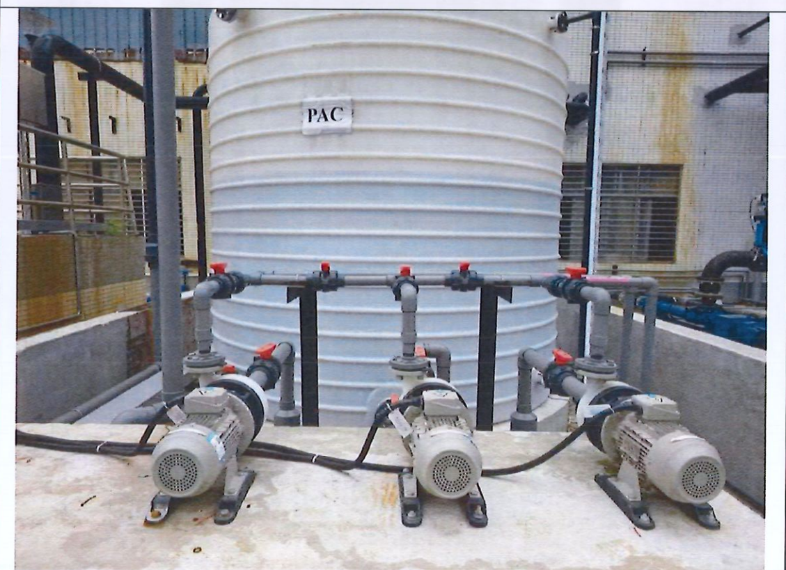
PAC 加药系统（污泥脱水机房）
