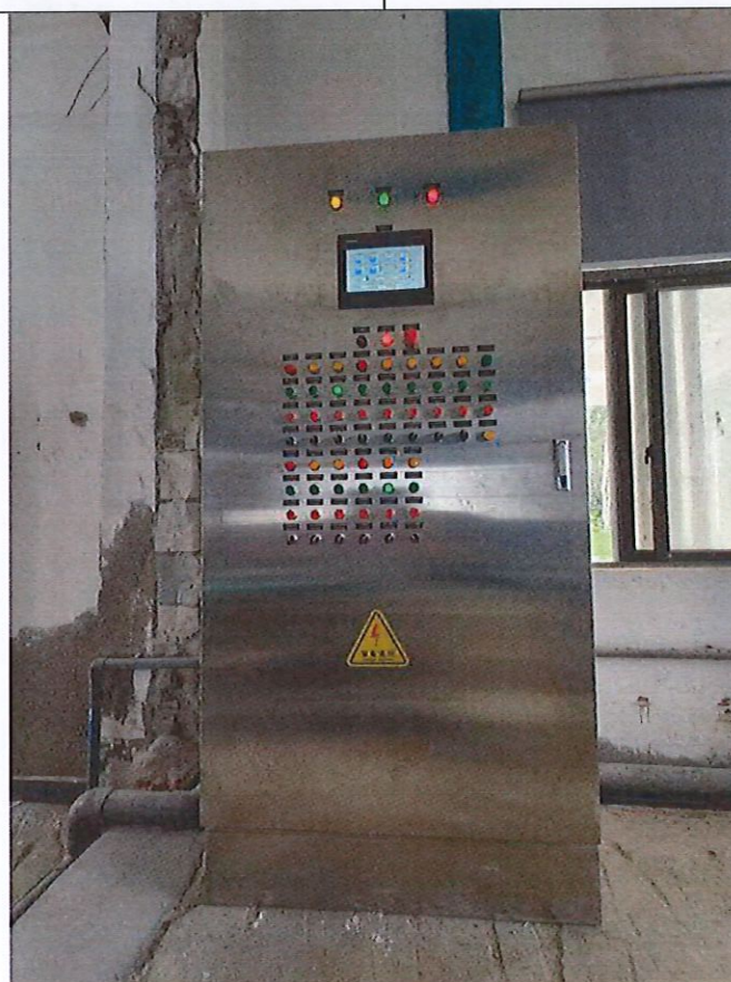
加药间加药控制系统
