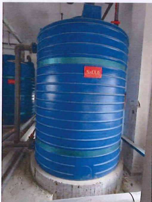
次氯酸钠储罐及围堰
