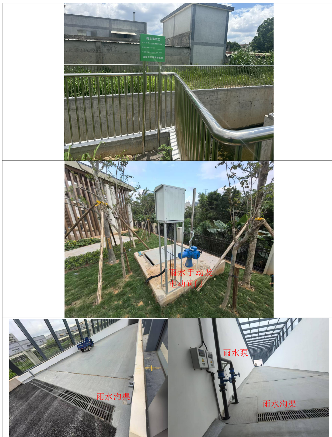
图 5.2-2 雨水排放口闸阀
